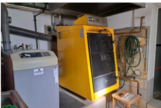
Heizraum im Keller
