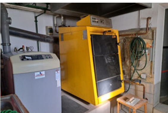
Heizraum im Keller
